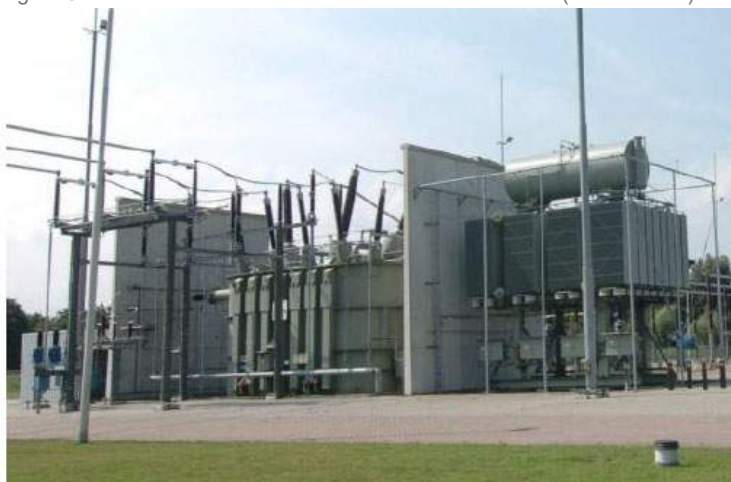
Figuur 5.2 Voorbeeld transformator in een transformatorcel (scherfmuren)
