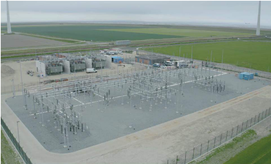
Figuur 4.6 Voorbeeld HS-station
