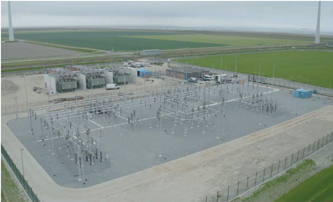
Figuur 4.5 Voorbeeld HS-station
