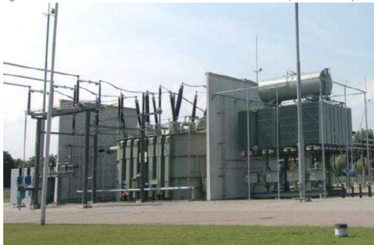
Figuur 5.2 Voorbeeld transformator in een transformatorcel (scherfmuren)
