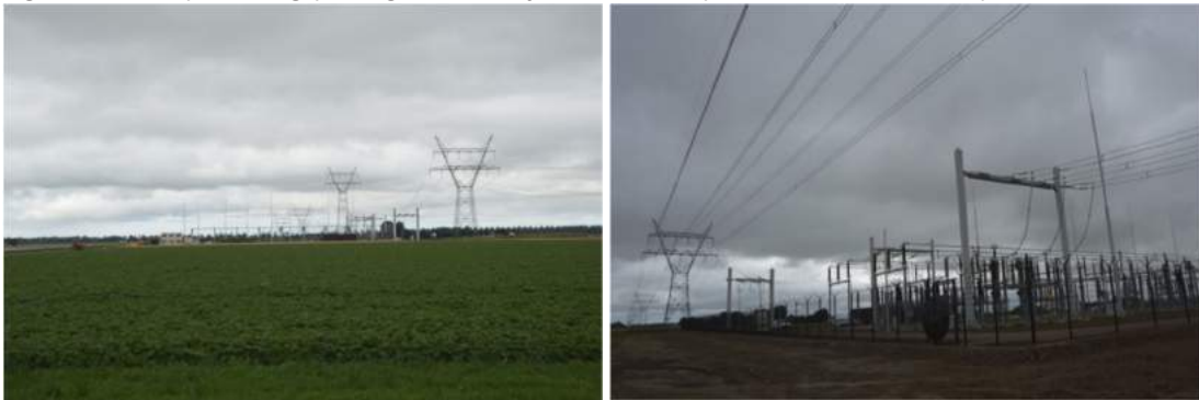
Figuur 5.7 Zicht op een hoogspanningsstation nabij Dronten, links op circa 450 meter, rechts op circa 15 meter afstand
