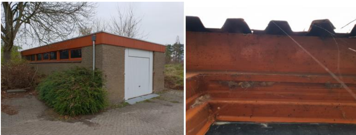
Figuur 3-3 Opening bij golfplaat bij garage Foto's RHDHV 2018.
