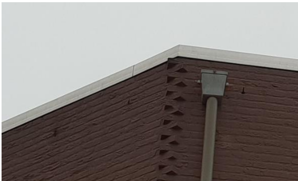
Figuur 3-2 Open stootvoegen in het kantoorpand. Foto RHDHV 2018.
