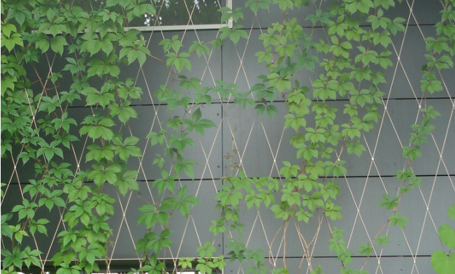
RVS kabelnet als hekwerk en klimhulp tussen stalen profielen
