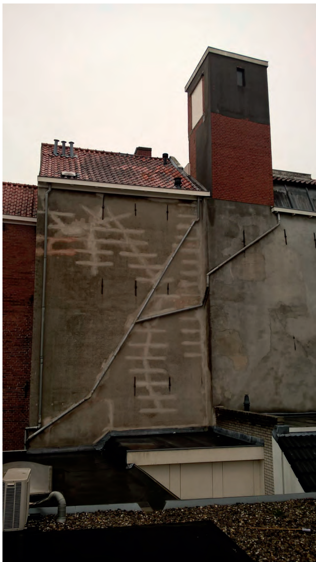
Door middel van 'wokkels' herstelde mijnbouwschade die vaak weer tot vervolgschade leidt. Foto: gemeente Groningen.
