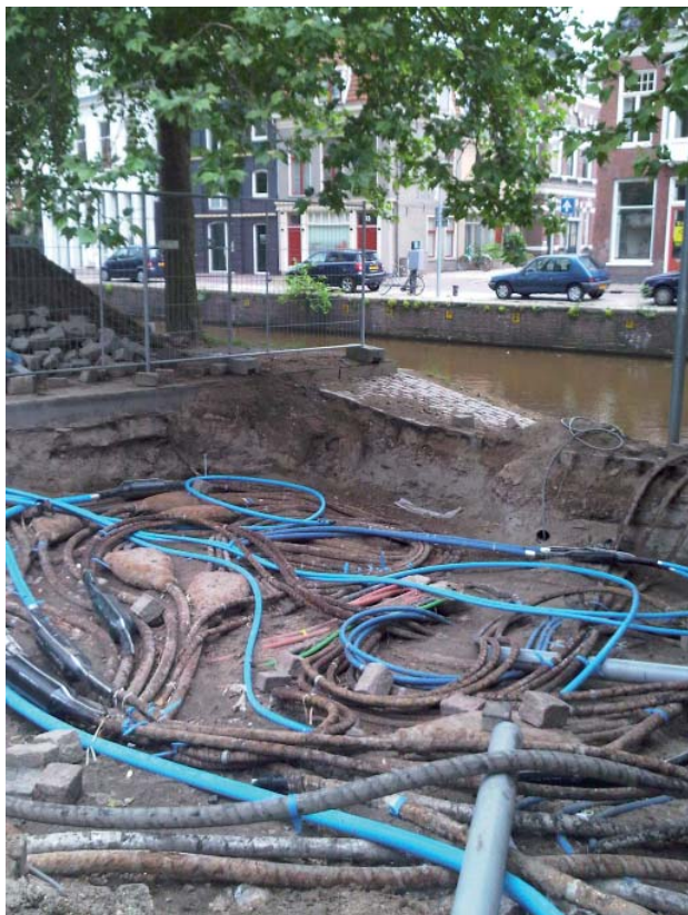
Zichtbaar raakvlak ondergrondse infra en bomen
