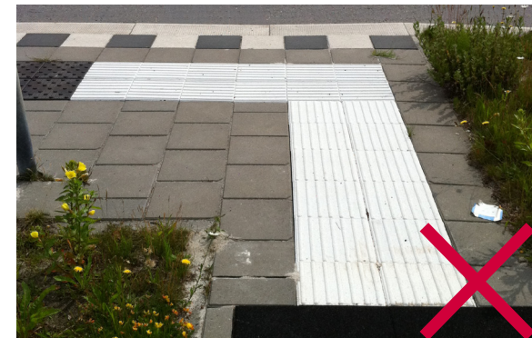
geleidelijn: kleur- en materiaalgebruik niet afgestemd
