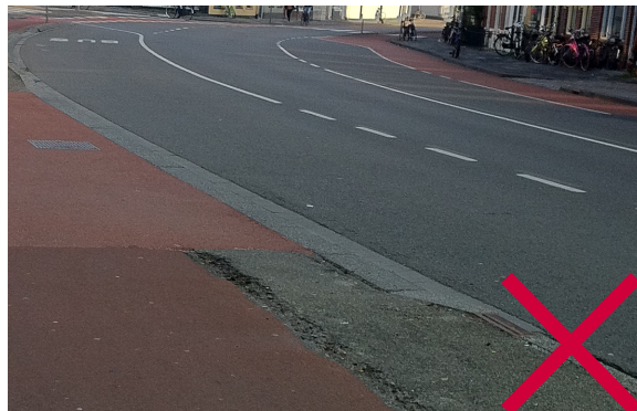
strook in (slecht afgewerkt) asfalt, slordige aansluiting
