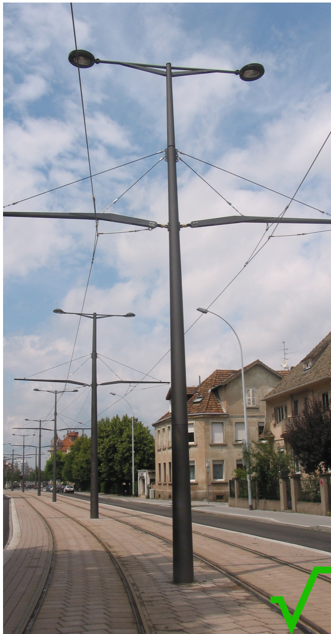
conische integraal ontworpen bovenleidingsmast
