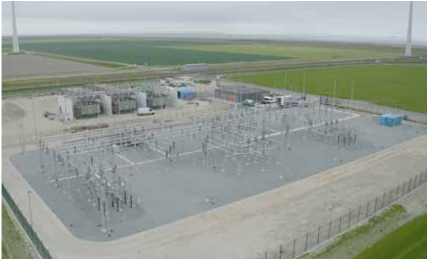
Voorbeeld van een middenspanningsstation (Eemshaven, bron: Tennet) 1
