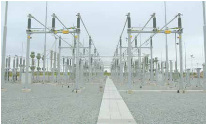
Voorbeeld van een middenspanningsstation (Eemshaven, bron: Tennet) 2
