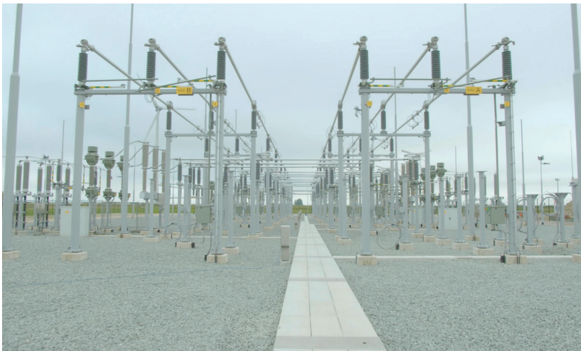
Voorbeeld van een middenspanningsstation (Eemshaven, bron: Tennet) 2
