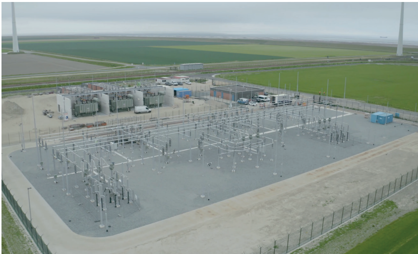
Voorbeeld van een middenspanningsstation (Eemshaven, bron: Tennet) 1
