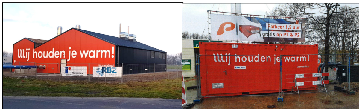
Figuur 15 Tijdelijke warmtecentrale
