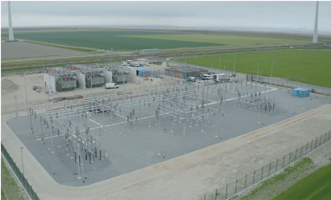
Figuur 4.5 Voorbeeld HS-station
