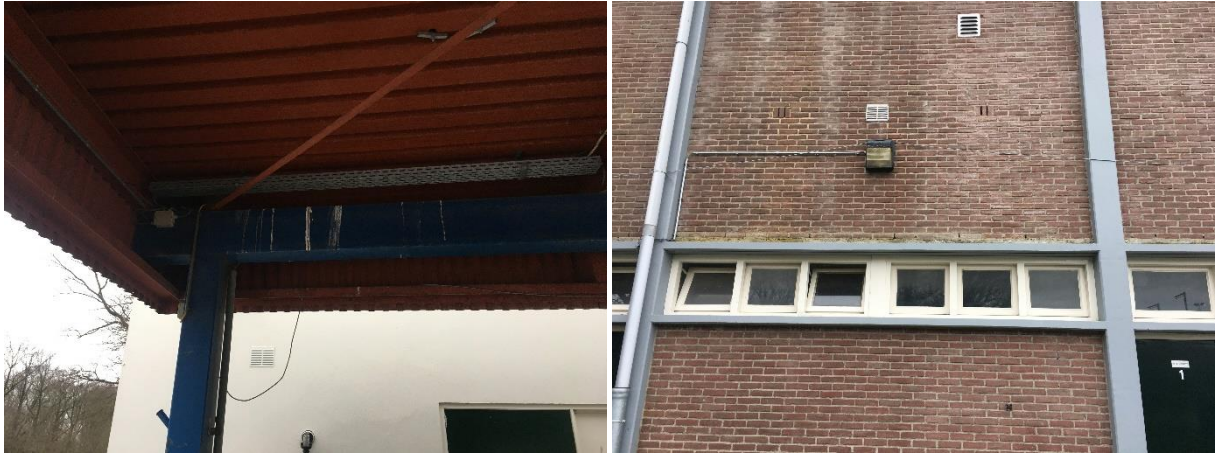
Afbeelding 11 en 12 Vogelsporen in het entreegebouw en open stootvoegen en ventilatieopeningen in een cateringgebouw.
