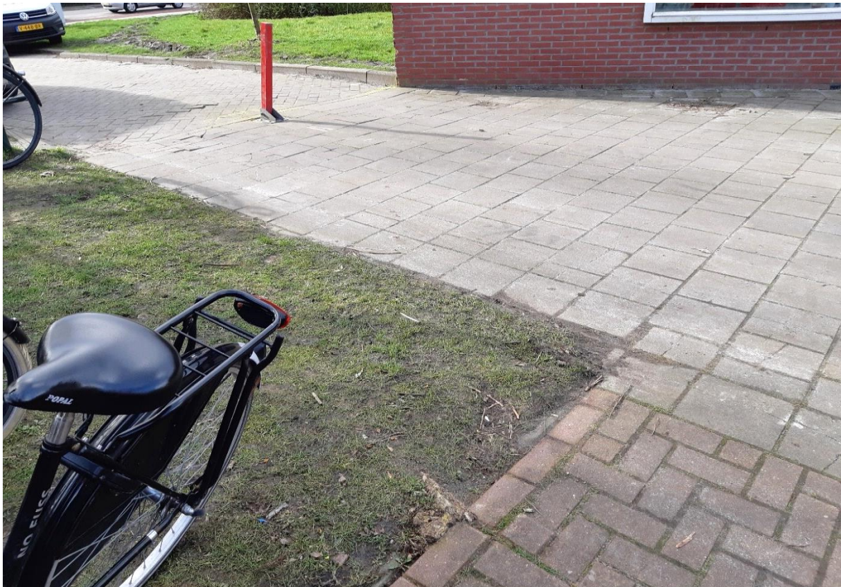
Foto 12: beeld van oppervlakkige beworteling en opgedrukte bestrating ter hoogte van entree
