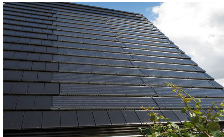
Duurzaamheidsmaatregelen als zonnecollectoren worden geïntegreerd ontworpen met de woning.
