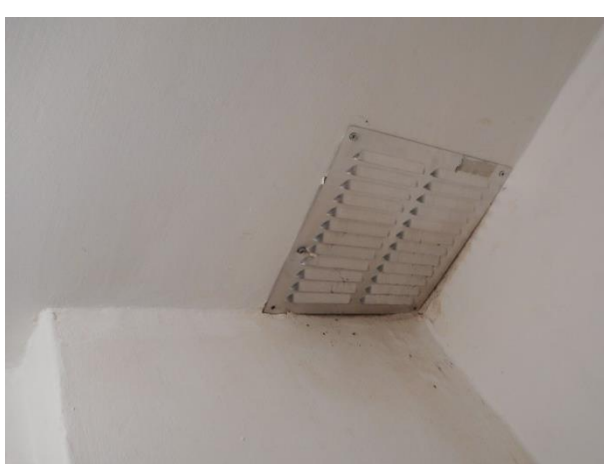
Natuurlijke ventilatie onvoldoende
