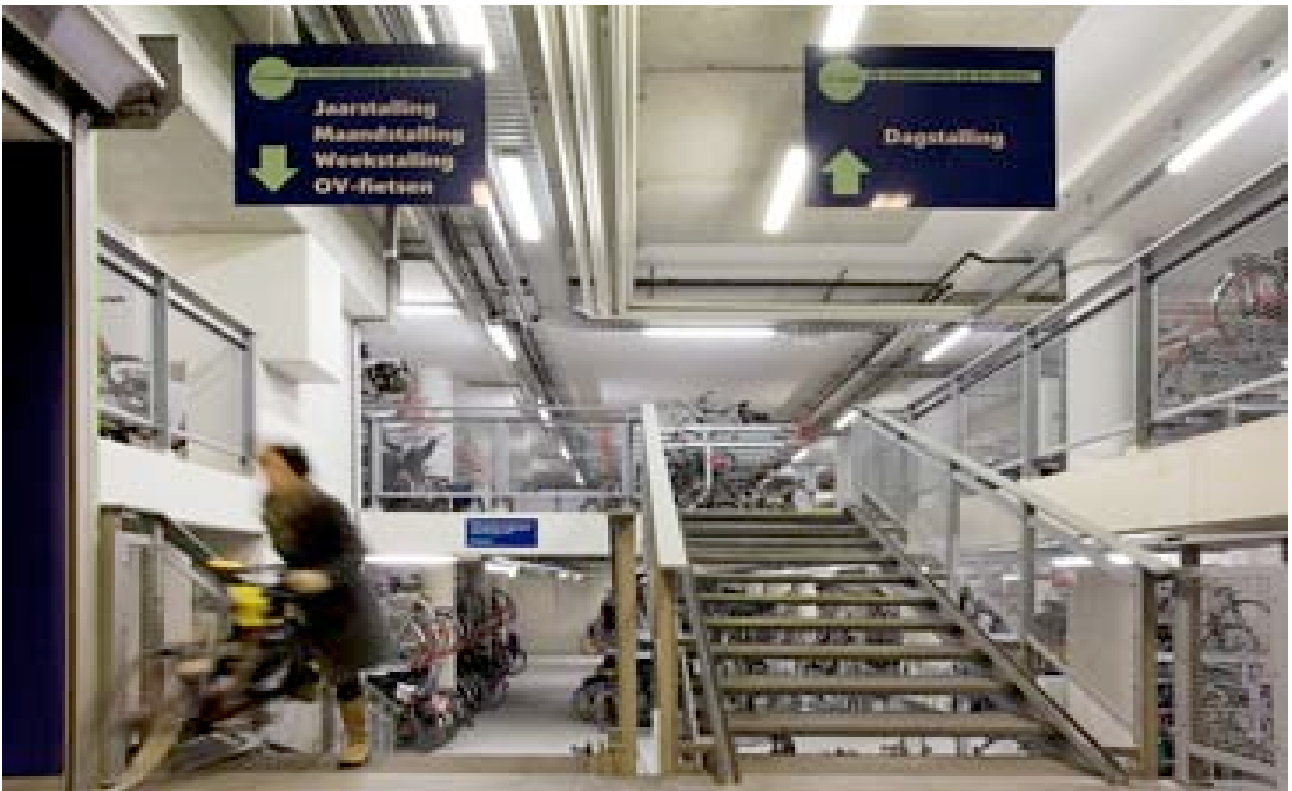
De fietsenstalling onder het stationsplein, naast de perron- en fietstunnel
