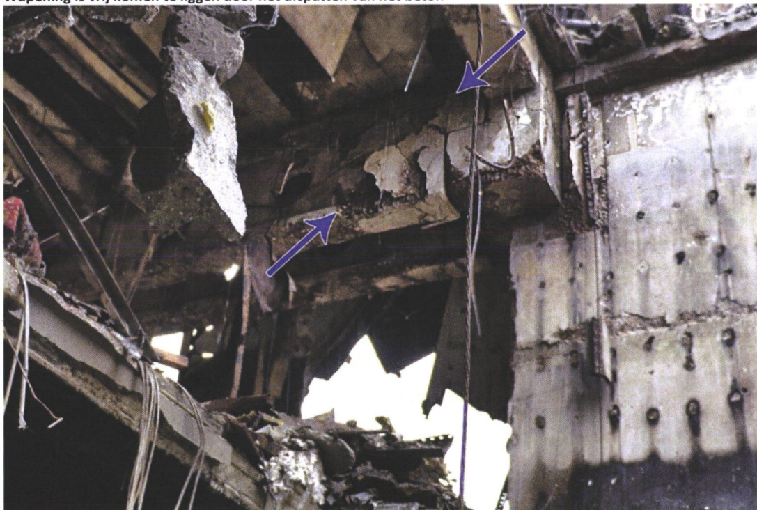
Oplegging betonnen ligger (opleg nok) wordt enkel door wapening bij elkaar gehouden. Constructieve sterkte is sterk afgenomen.
