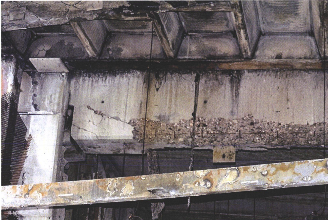
Wapening is vrij komen te liggen door het afspatten van het beton
