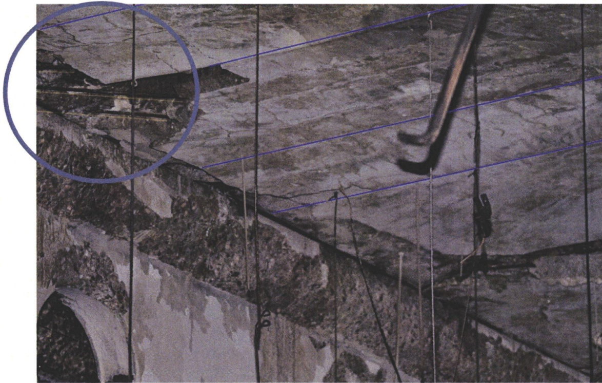
Voorgespannen wapening ligt volledig bloot. Ter plaatse van de oplegging is de vloer geknikt. Zie de hoek van de wapening ten opzichte van vloerplaat.
