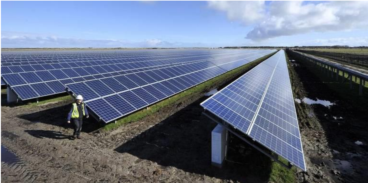
Figuur 5 Lokaal coöperatief 10 ha groot zonnepark van Amelander Energie Coöperatie (foto van de aanbouwfase, opgeleverd begin 2016)
