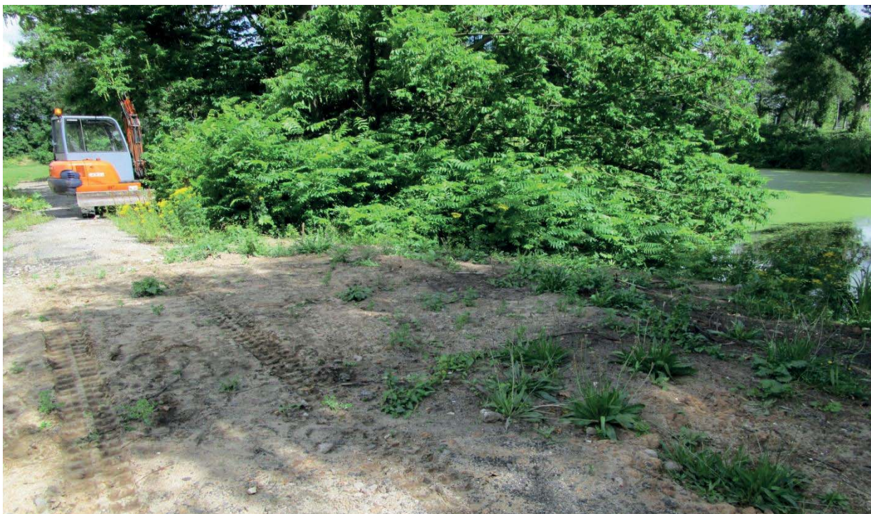
Beeld van recente graafwerkzaamheden t.b.v. de aanleg van een leiding (zuidzijde van boom 154)
