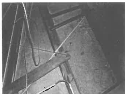
foto 3, M1, bovenzijde plafond
