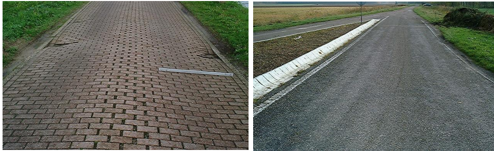
Figuur 2 Schades dwars onvlakheid en rafeling
