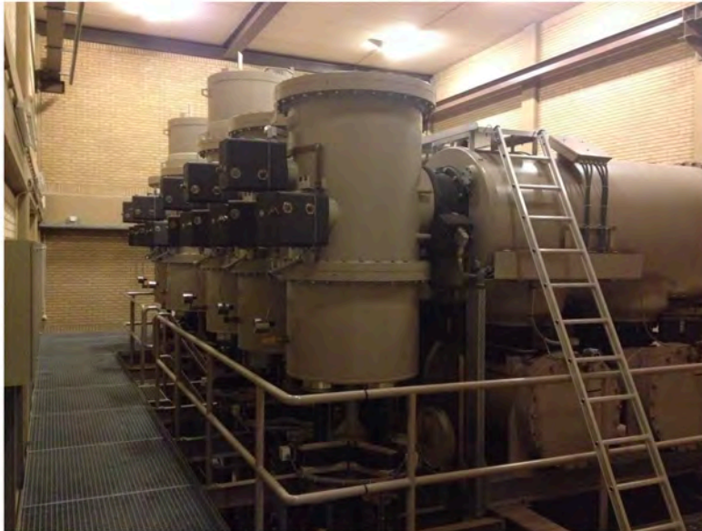
Figuur 2.16 Foto van een dergelijke installatie.
