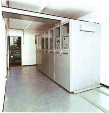
Installatie met speciale railkokersaansluiting.
