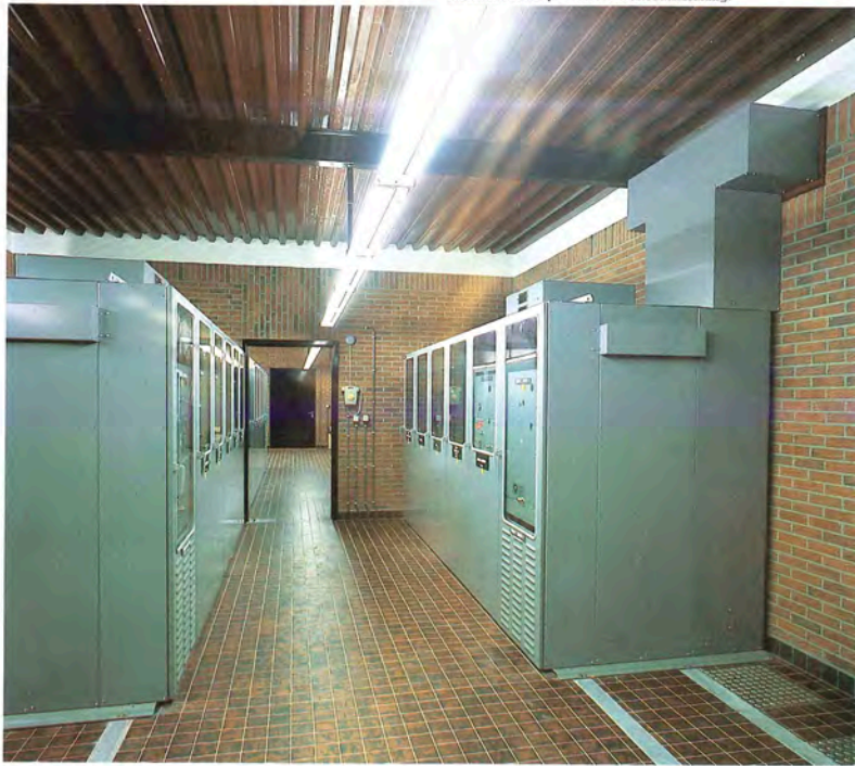
Front-aan-front-opstelling met muurdoorvoering van rails naar de transformator.
