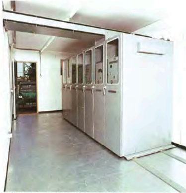
Installatie met speciale railkokersluiting.
