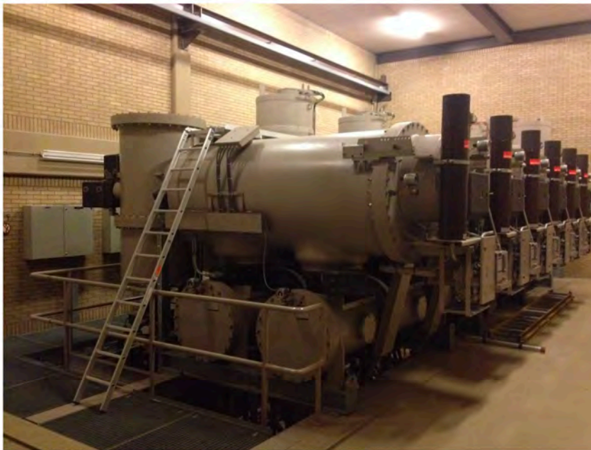
Figuur 2.24 Foto van een dergelijke installatie.
