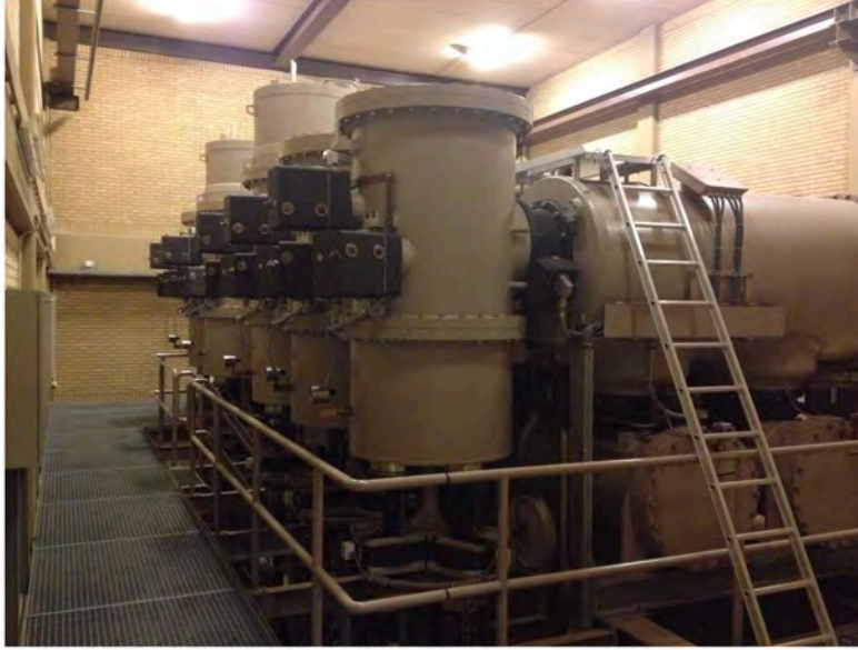
Figuur 2.23 Foto van een dergelijke installatie.
