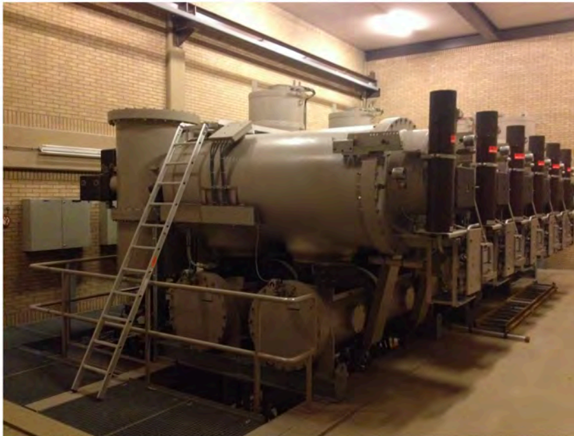
Figuur 2.17 Foto van een dergelijke installatie.
