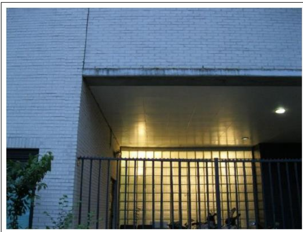
Figuur 11. De aanvlieglocatie van gewone dwergvleermuis aan de zuidzijde van het gebouw. Hier zijn enkele open stootvoegen aanwezig (foto afkomstig uit K&B rapport 2016-038).
