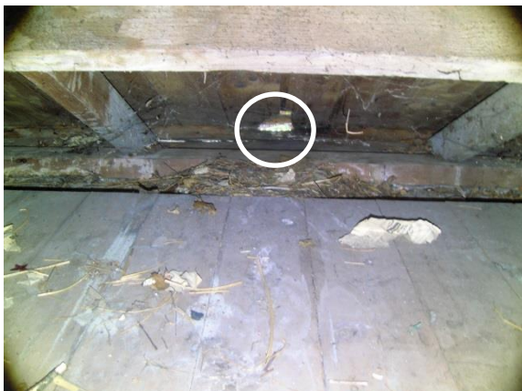
Foto 4 Gat in het dakbeschoot in het oudste deel van het voormalig scholencomplex.
