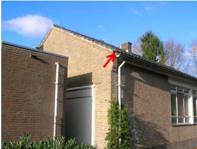
Foto 2 Ruimtes in de onderste rij dakpannen die mogelijk toegang bieden voor broedende Huismussen.
