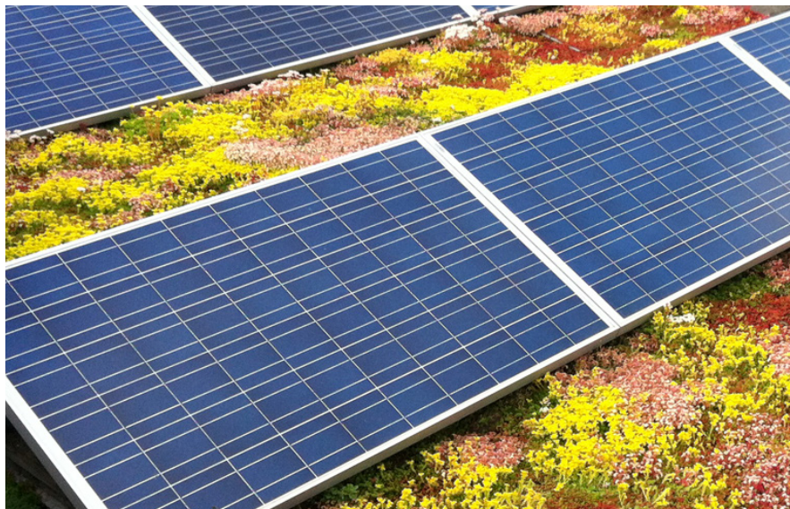
Zonnecollectoren op groen dak.
