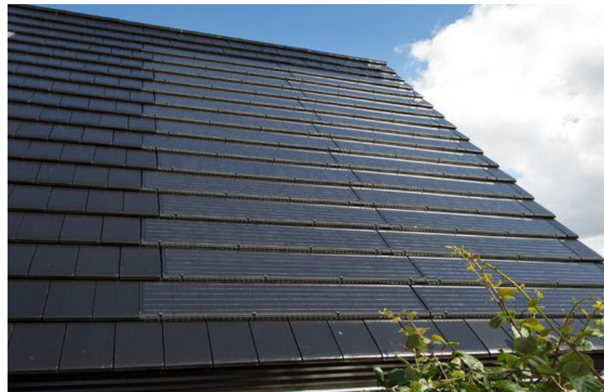
Duurzaamheidsmaatregelen als zonnecollectoren worden geïntegreerd ontworpen met de woning.
