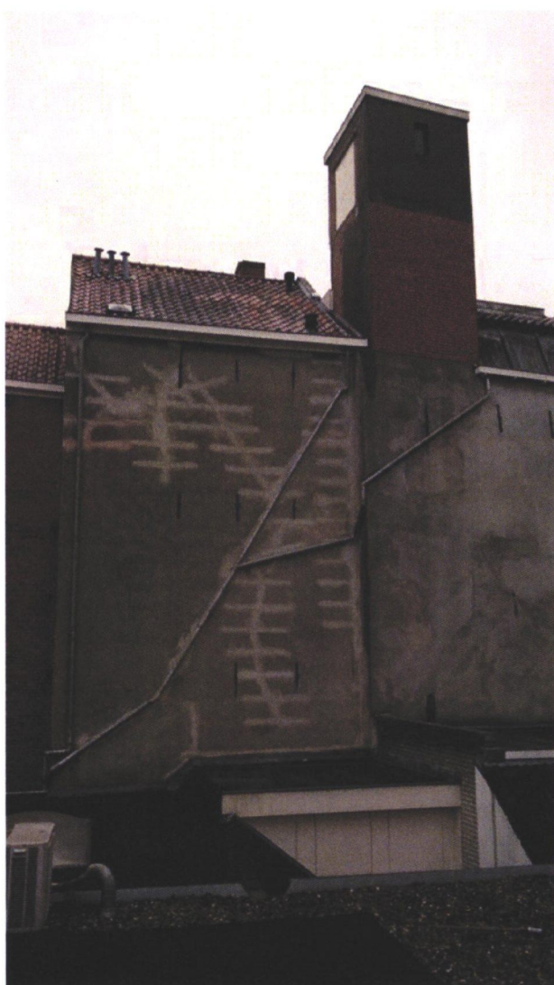
Door middel van 'wokkels' herstelde mijnbouwschade die vaak weer tot vervolgschade leidt. Foto: gemeente Groningen.
