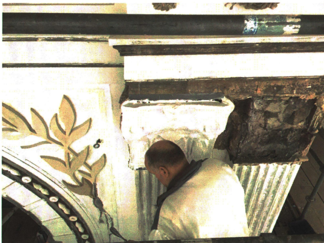
Tijdens de uitvoering is besloten om 4 stuks kapitelen geheel nieuw te maken. Van een nog goede kapiteel is een mal gemaakt van kunststof
