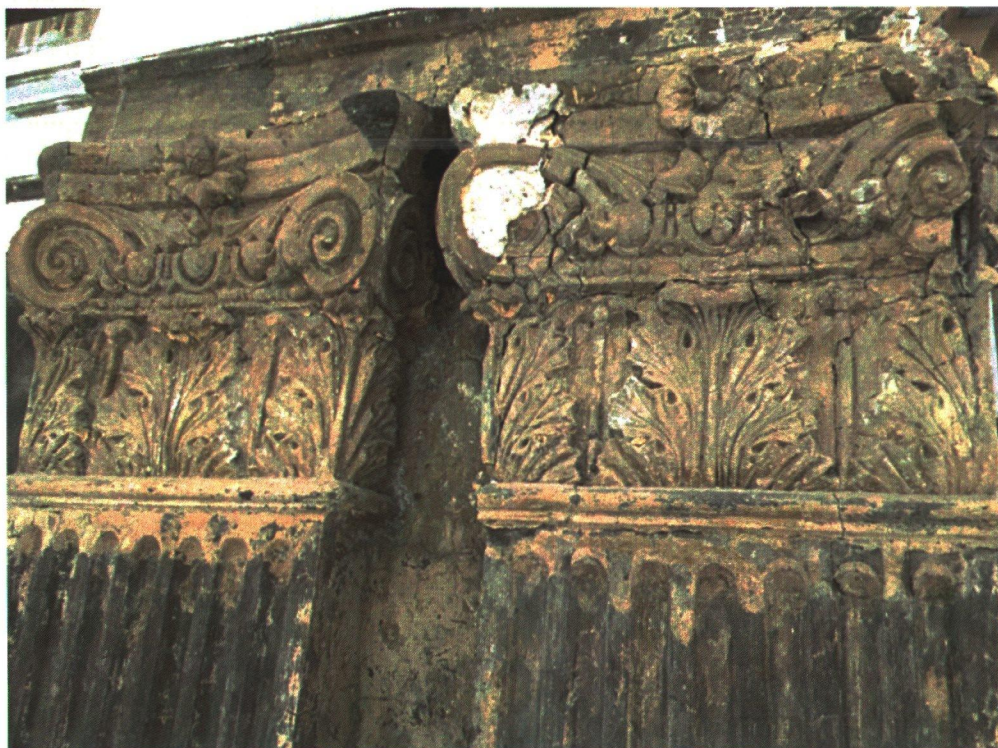
Zwaar beschadigde kapitelen naast en boven de entree.
