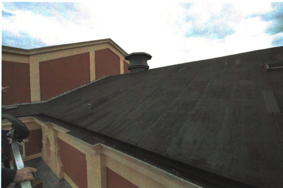
Doorgeplakt bitumen over dak en in de goot, met openstaande naden en bijlapwerk.
