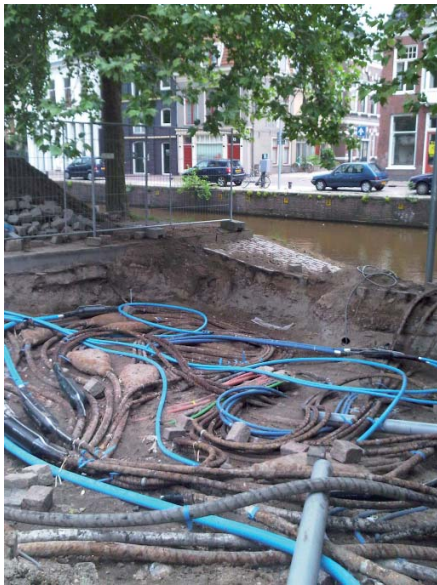
Zichtbaar raakvlak ondergrondse infra en bomen
