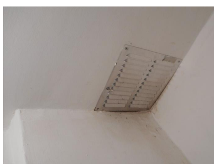
Natuurlijke ventilatie onvoldoende
