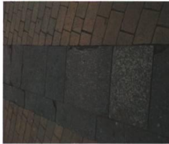
Verharding : breuk door zware belasting.
