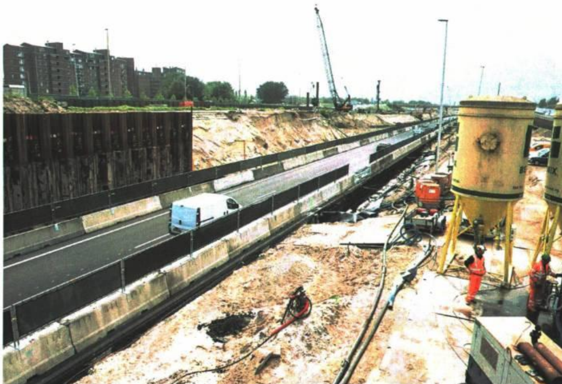
De werkzaamheden aan de Gaasperdammerweg leiden tot bevestigingschade bij huizen van omwonenden. FOTO RIJKSWATERSTAAT/GERRIT SERNE
