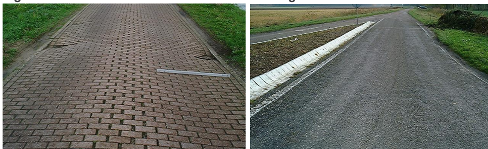
Figuur 1 Schades dwarsonvlakheid en rafeling
