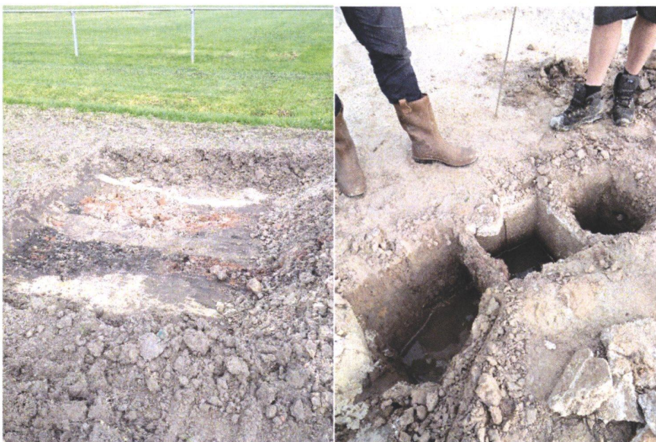
Foto; aangetroffen puin en oude putten in de ondergrond ( onvoorzien)
