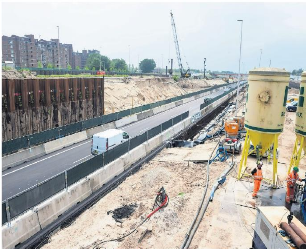
De werkzaamheden aan de Gaasperdammerweg leiden tot bevestigsschade bij huizen van omwonenden. FOTO RIJKSWATERSTAAT/GERRIT SERNE
