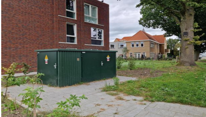
Afbeelding: elektriciteitshuisje PACTO 20
