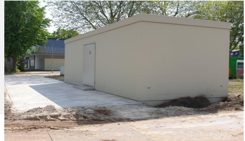
Afbeelding: schakelstation in Borger
